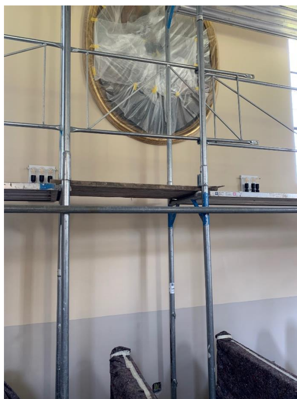
Innen wurde im Juni mit dem Farbanstrich mit einem neuem Farbmuster begonnen.
